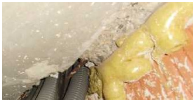
Einsatz von PU Schaum ist verboten
