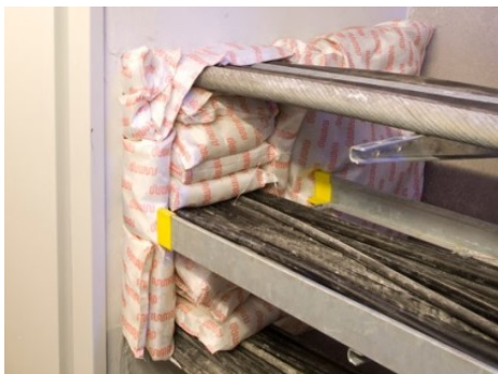
Brandschutzkissen als eine Dauerlösung sind verboten
