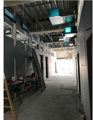
Lüftungsinstallation Korridor Konferenz
