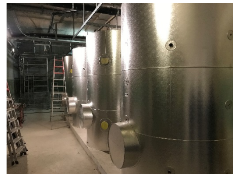
Neu aufgestellte Warmwasserspeicher im 2. UG des Bestandsgebäudes (ehemalige Tankräume)
